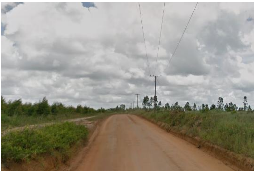
Figura 40: ES-010 antes da obra
